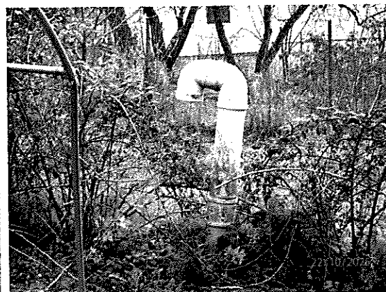
Potrubie rekuperácie k domu na pozemku
