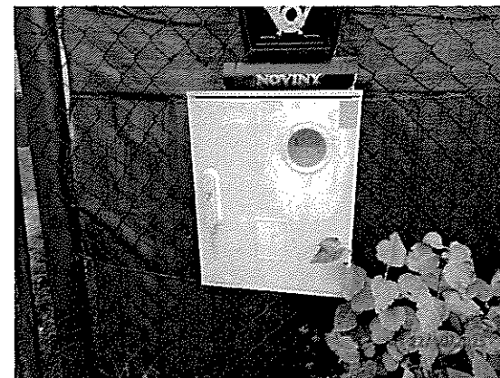
Elektromerná skrinka pred domom
