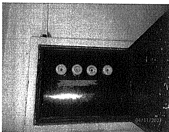
Pôvodný rozvádzač ELI v byte
