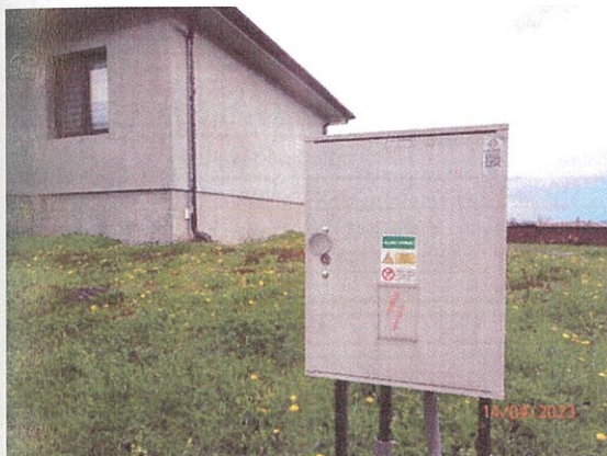
Elektromerná skrinka pred domom
