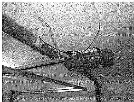
Automatické otváranie vrát garáže
