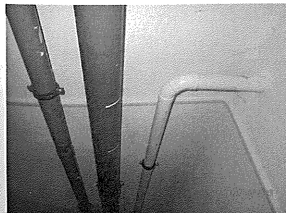
PVC rozvody kanalizácie a vysávača
