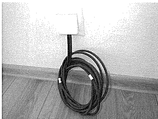
Rozvod slaboprádu na II.NP
