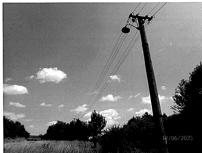
Vzdušný NN rozvo elektro na južnej strane parc. 3237/24
