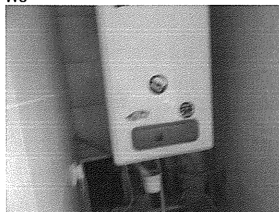
Plynový kotol v kúpeľni
