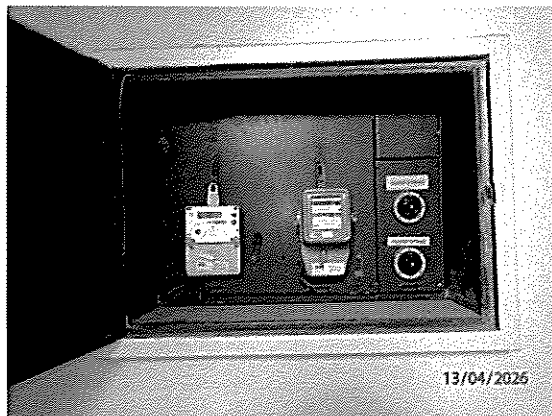
Elektromery pre byty na 1.poschodí na chodbe
