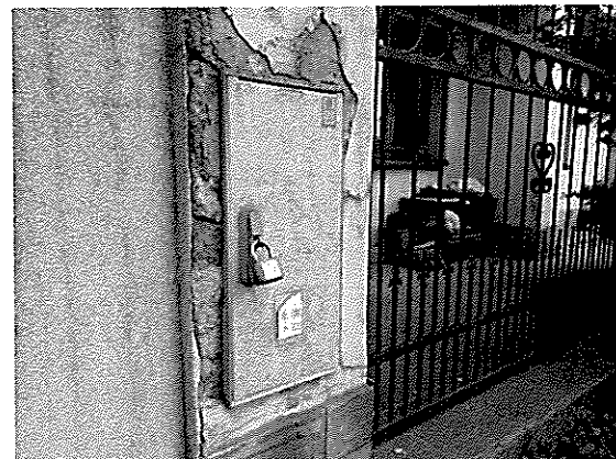
Elektromerná skrinka pred domom
