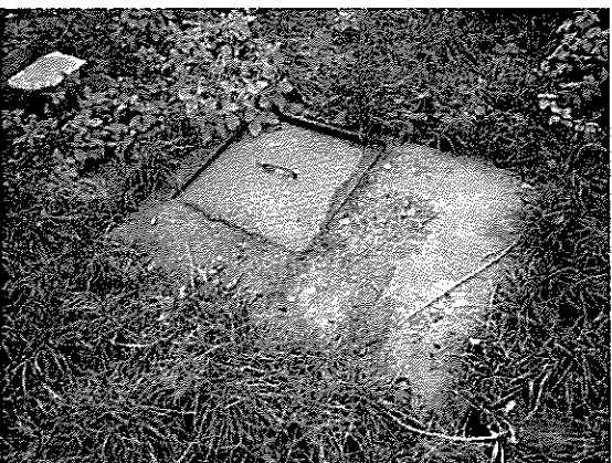
Vodomerná šachta pred domom
