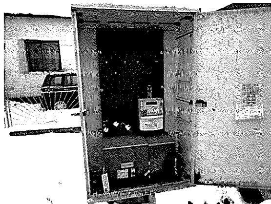
Elektromer pre rodinný dom na stĺpe na ulici pred domom
