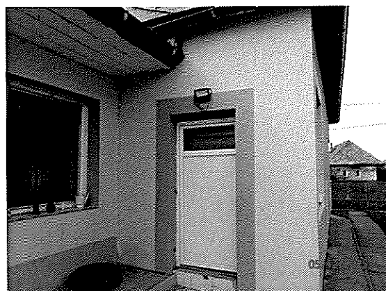
Nefunkčný vstup do verandy domu
