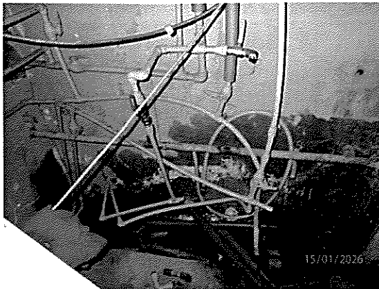
Neodborná „pavučina“ rozvodov vody
