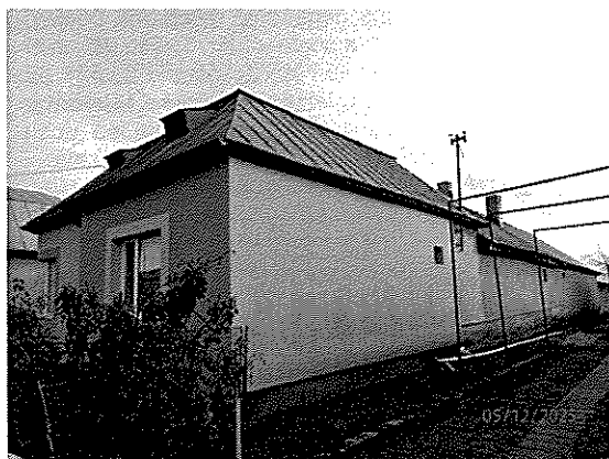
Zadná stena domu od suseda
